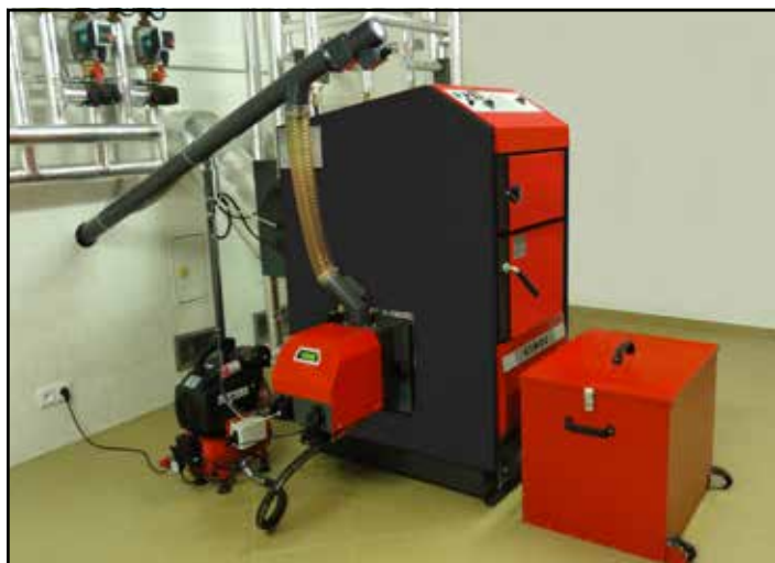
Příklad kotelny s kotlem D50P
