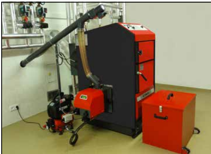
Příklad kotelny s kotlem D50P
